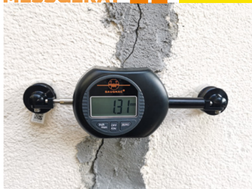
Auf Platinen gesteckter Rissmonitor zur Messablesung
